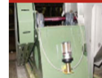
Lubricación de ventiladores en industria alimentaria
